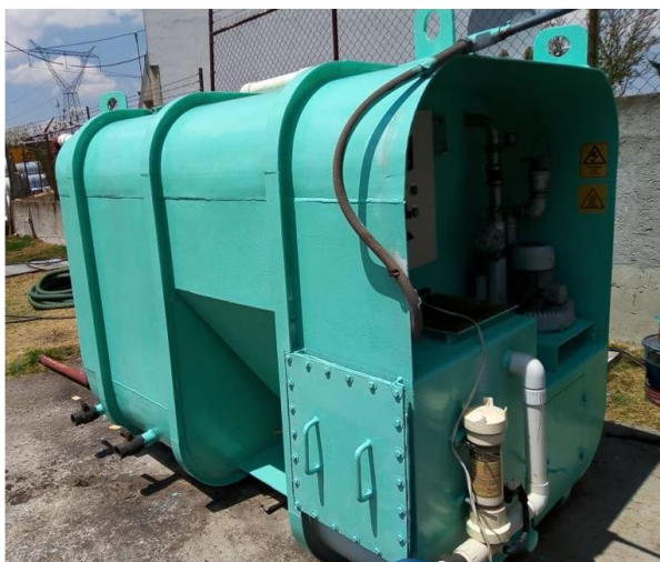
Reactor de lodos activados
